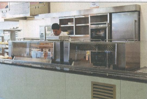
Integriert in die Speisenausgabe: zwei effiziente Front-Cooking-Stationen.
